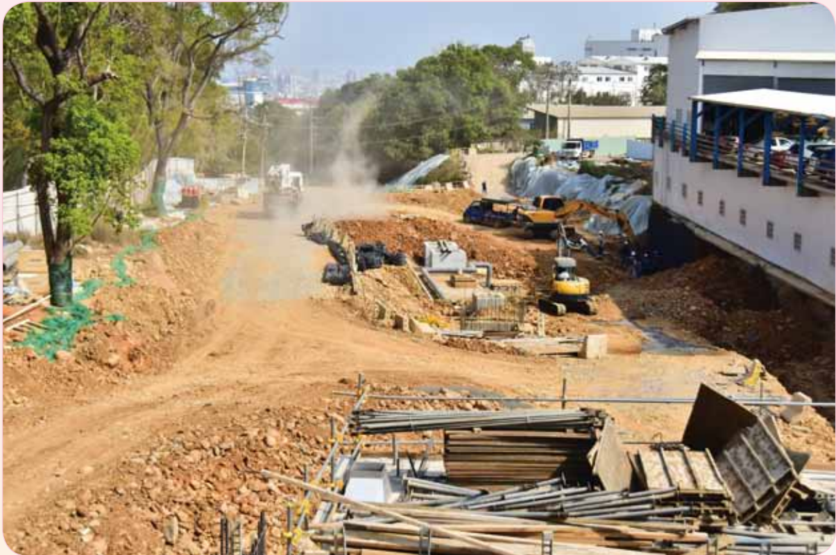
圖十二：「東大溪水環境及鄰近區域環境改善計畫」硬體工程（施工中）
